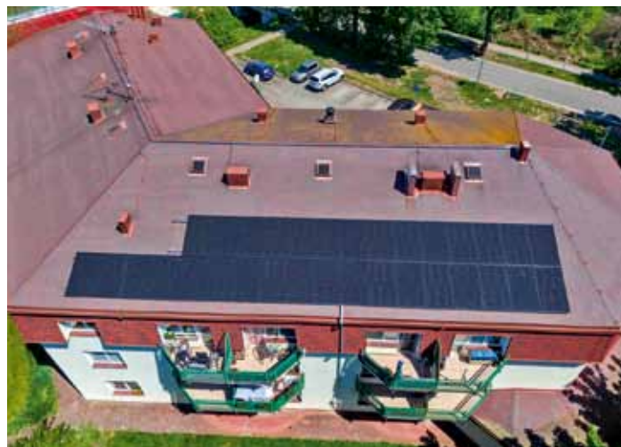
Fotovoltaiky na městských budovách jsou dokončeny – budova DPS
