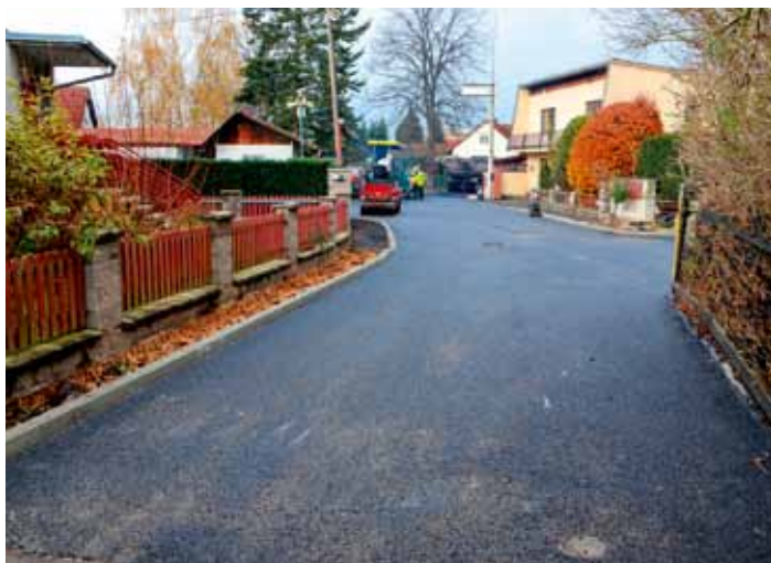
Ulice Na Koutě má nový asfaltový povrch. V přípravě je pokládka chodníků - listopad 2024
