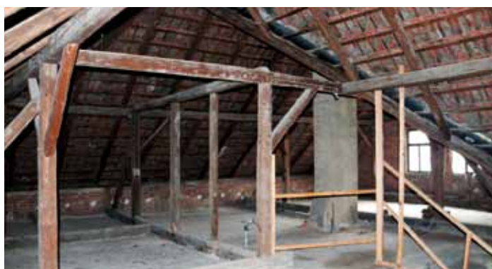
V těchto půdních prostorech budovy mat. školky ve Školní ulici, budou vybudovány 3 bytové jednotky
